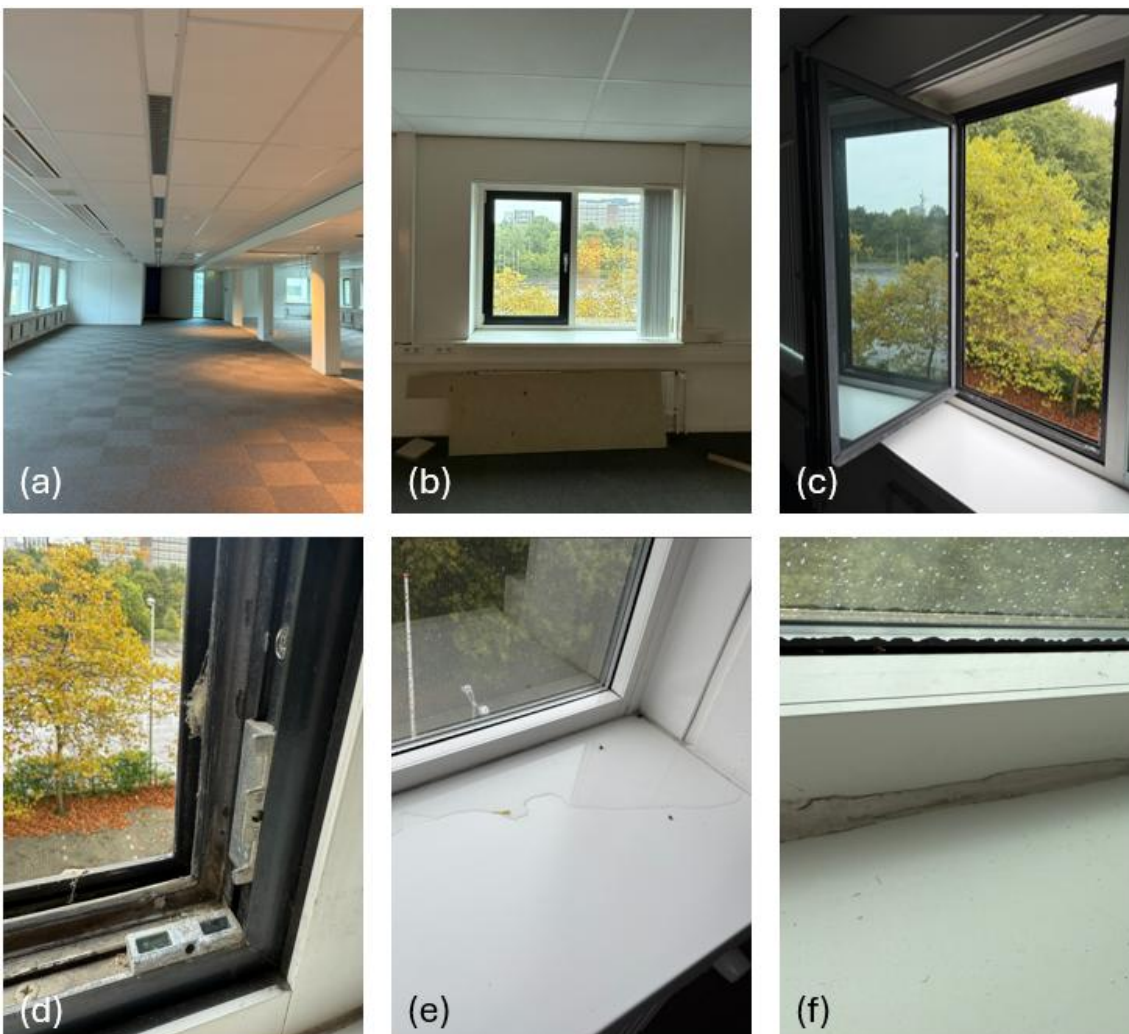
Figuur 3: (a) Aanzicht binnenzijde (b) representatief raamdeel (c) draairaam (d) dubbele kierdichting (e) lekkage (f) kitnaad binnenzijde kozijn
